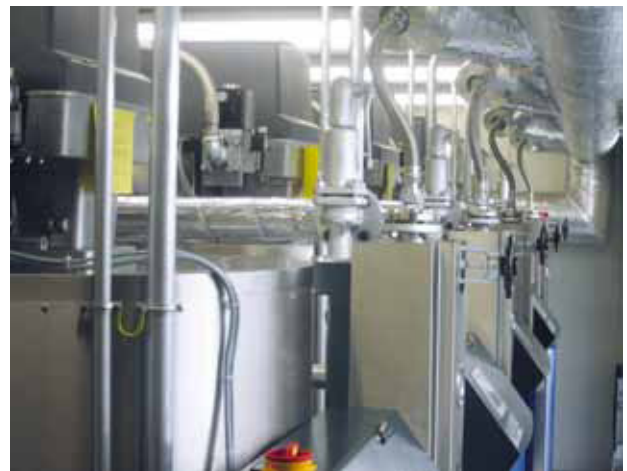
Slika: Postrojenje parnih generatora instalirano u kontejneru
