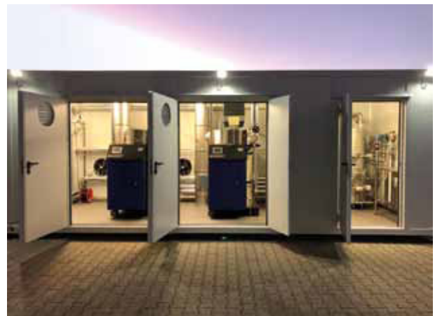
Slika: Postrojenje parnih generatora instalirano u kontejneru
